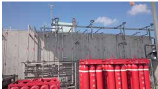
自治体の行政指導により 散水設備を設置したスタンド
