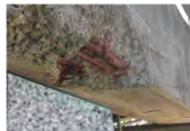
損傷状況(鉄筋露出)
