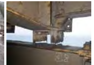
シェッド主梁端部破断
