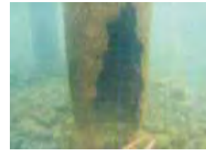
橋脚水中部の 断面欠損
