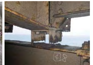
▲シェッド主梁端部破断
