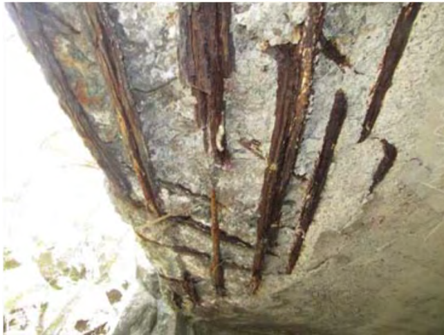
国管理 床版鉄筋露出 ※床版:橋の裏側
