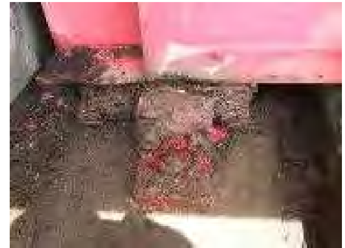
地方自治体管理 支承腐食
