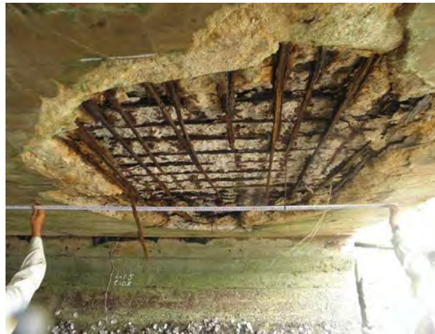
地方自治体管理 床版鉄筋露出
