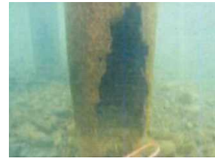
▲橋脚水中部の断面欠損
