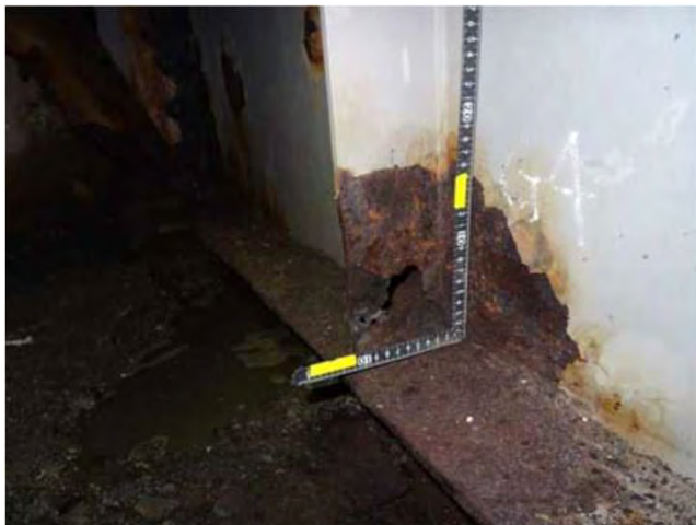
国管理 主桁腐食・欠損
