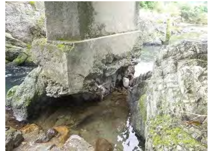
地方自治体管理 橋脚洗掘
