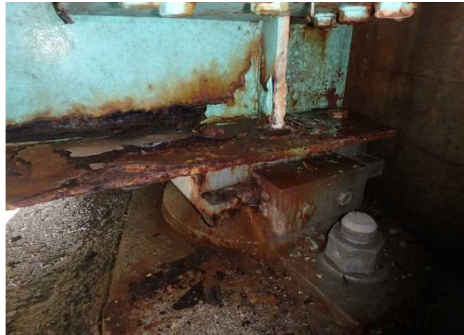
地方自治体管理 主桁腐食
