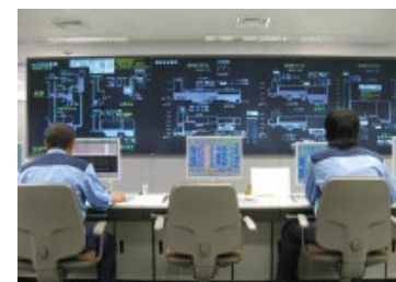
処理場の運転管理
