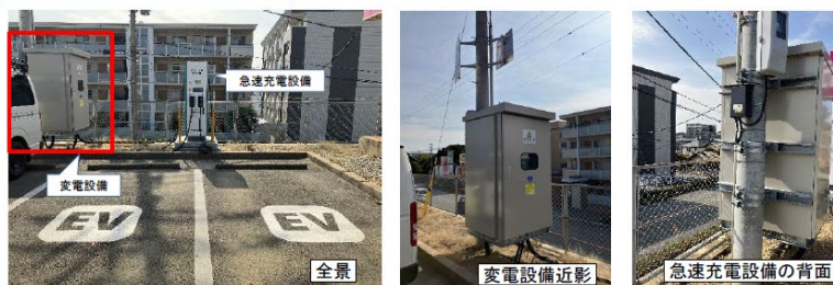
柱上設置の例
